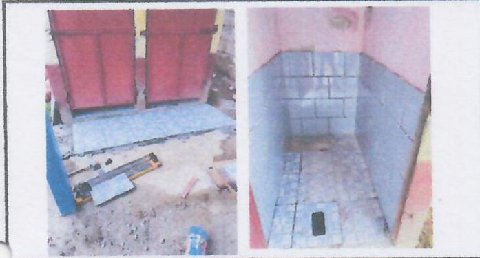
Foto 7: FUNDICION DE TORTA DE CEMENTO EN AREA DE REUBICACION DE PILA, INSTALACION DE PISO Y AZULEJO EN AREA DE BAÑOS .
