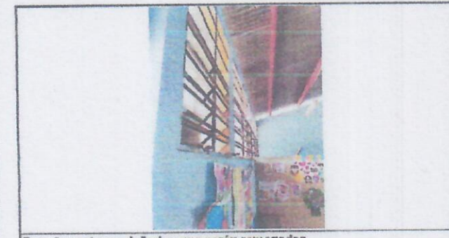
Foto 6: ventanas dañadas que serán remozadas.
