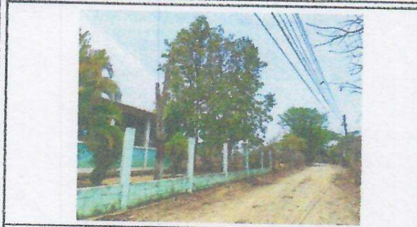
Foto 1: Muro perimetral el cual necesita cambio de malla.
