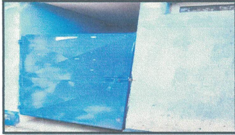
Foto 7: Mantenimiento a estructura (lijado, cambio de tubo, cepillado, sujeciones, aplicación de pintura) en puertas
