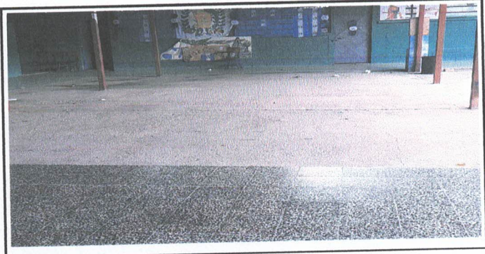
CONTINUIDAD DE PISO DE GRANITO
