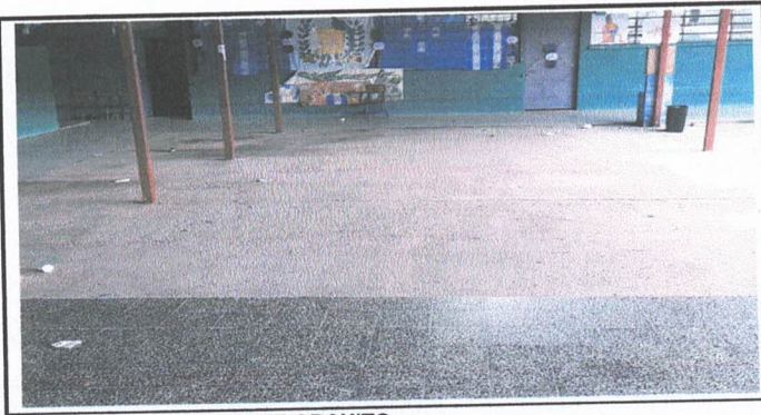
CONTINUIDAD DE PISO DE GRANITO
