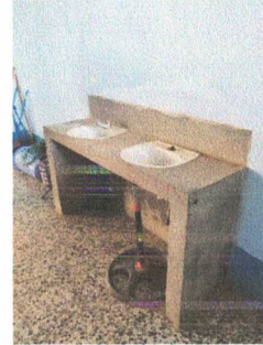
Foto 2: Lavamanos que necesitan cambio de accesorios y sifon.
