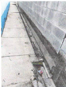
Foto 5: Ubicación de cuneta, la que se tiene esta dañada.
