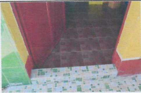
Foto 9: REPARACION DE PUERTA METALICA Y MANTENIMIENTO, COMO TOPE PARA EVITAR QUE EL AGUA DE LLUVIA INGRESE.
