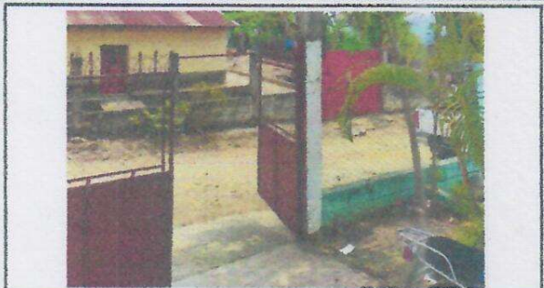
Foto 2: Porton que necesita reparación y mantenimiento.
