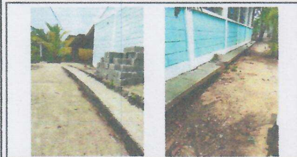
Foto 3: Acera que esta lastimada y que necesita ser reparada.
