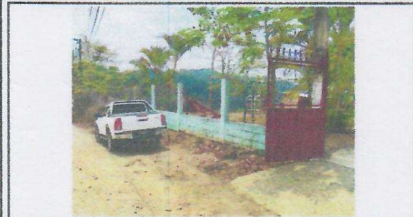
Foto 1: Muro exterior con malla dañada que necesita cambio.
