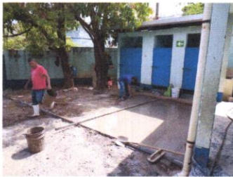
Foto 3: Sustitución de plancha de concreto en el patio por una plancha de concreto.
