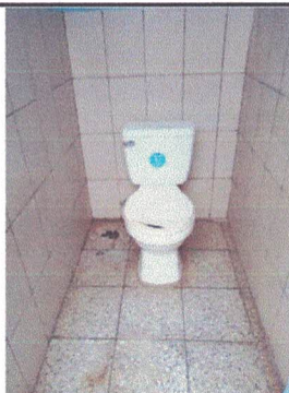
Foto 3: baños en mal estado que serán sustituidos
