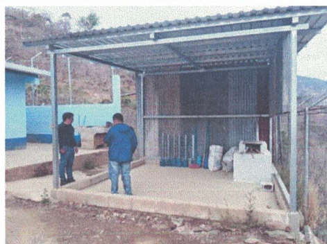
Foto 2: cocina que necesita mejoramiento para cerrar verticalmente con estructura metálica, se colocara puerta y ventana.
