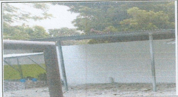
Foto 7: CERNIDO EN MURO PERIMETRAL
