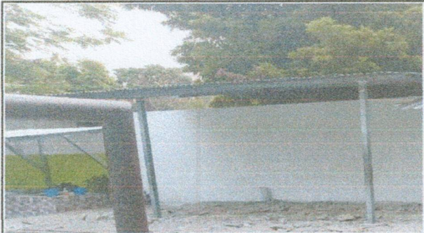
Foto 7: CERNIDO EN MURO PERIMETRAL
