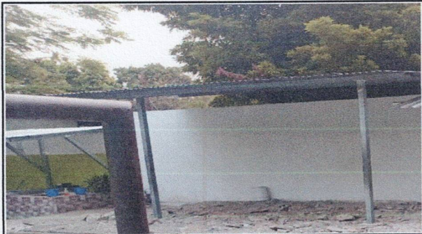
Foto 7: CERNIDO EN MURO PERIMETRAL
