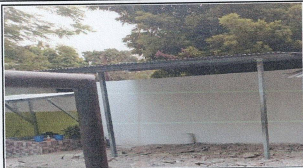
Foto 7: CERNIDO EN MURO PERIMETRAL
