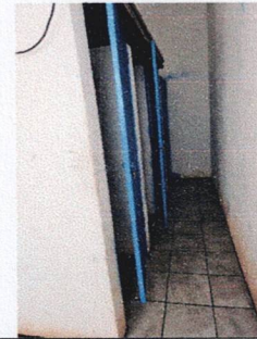
Foto 4: Piso en Servicios Sanitarios y Mantenimiento de Puertas
