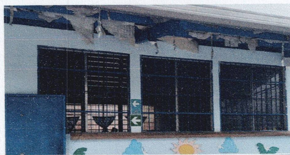
Foto 4: Mantenimiento a Balcones, Desinstalación de ventas milfinish y Sustitución de Ventanas de PVC con Vidrio. Y Aplicación de Pintura Latex para interior y exterior en AULA PURA y hasta donde cubra la cantidad indicada.
