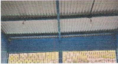
Foto1: Luminarias del aula.
