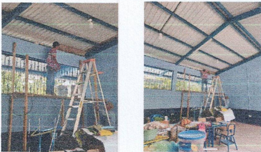
Foto 5: Entavicación de muro en aula.
