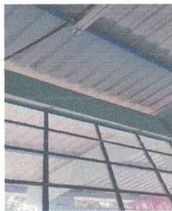
Foto 5: Falta de entavicar muro en aula.
