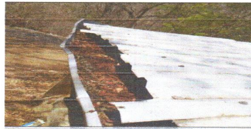
2. SUSTITUCIÓN DE CANAL DE METAL POR OTRO CANAL DE METAL ATRÁS DE LA ESCUELA
