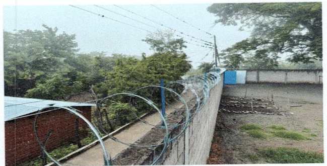
Foto 6 Protección de muro perimetral con Razor Ribbon
