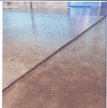
Foto 10: Reparación de Base en mal estado y Sustitución de Piso torta por Piso Cerámico.
