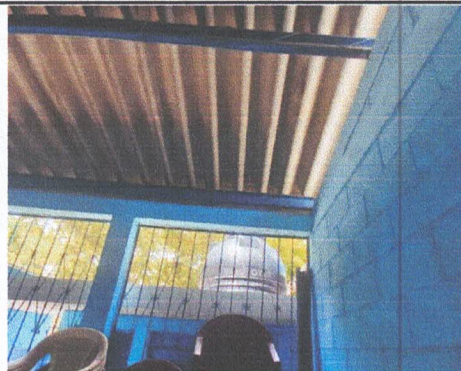
Foto 2: Reparación de Cubierta de Techo de AULA. Debe Removerse la Lámina Perfil 10 o de Asbesto cemento para darle Mantenimiento a la Estructura Existente y Luego Sustituir Lámina Troquelada C26 Legítima.
