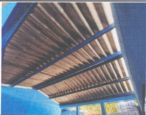
Foto 3: Reparación de Cubierta de Techo de AULA. Debe Removerse la Lámina Perfil 10 o de Asbesto cemento para darle Mantenimiento a la Estructura Existente y Luego Sustituir Lámina Troquelada C26 Legítima.
