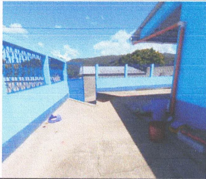
Foto 9: Sustituir Estructura Existente y Luego Sustituir Lámina Troquelada C26 Legítima en PATIO Y ACCESO PRINCIPAL.
