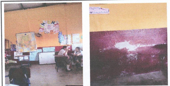
Módulo Aula 3: 3.1 Instalación de piso cerámico, 3.2 Sustitución de ventiladores, 3.3 Sustitución de puerta, 3.4 Reparación de repello de una pared, 3.5 Pintura de paredes
