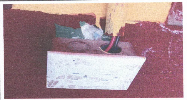
Sistema Electrico: Sustitución de sistema de poder y fuerza para ventiladores
