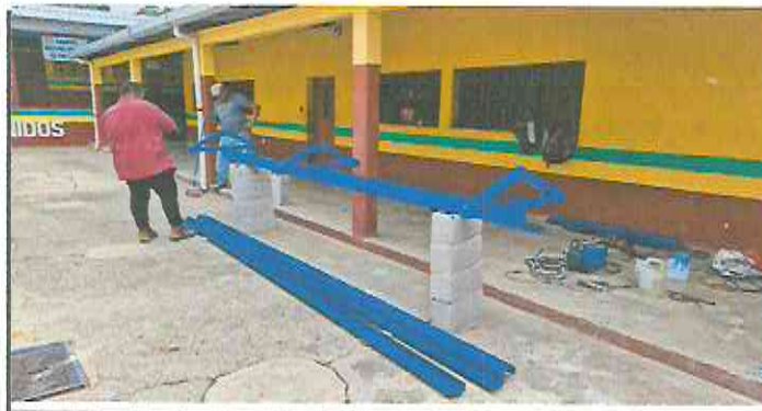
Foto 5: Sustitución de portón de ingreso de 2.5m x 4.00m y techado en área de portón con costanera + lamina troquelada aluzinc cal. 26.
