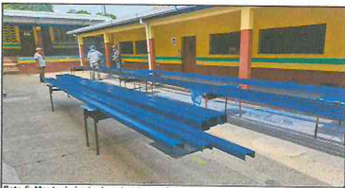
Foto 5: Mantenimiento de estructura existente (limpieza, lijado y pintura anticorrosiva), reforzamiento de estructura con costanera de 2x4.
