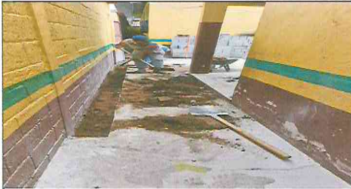
Foto 1: Sustitución de portón de ingreso de 2.5m x 4.00m y techado en área de portón con costanera + lamina troquelada aluzinc cal. 26.
