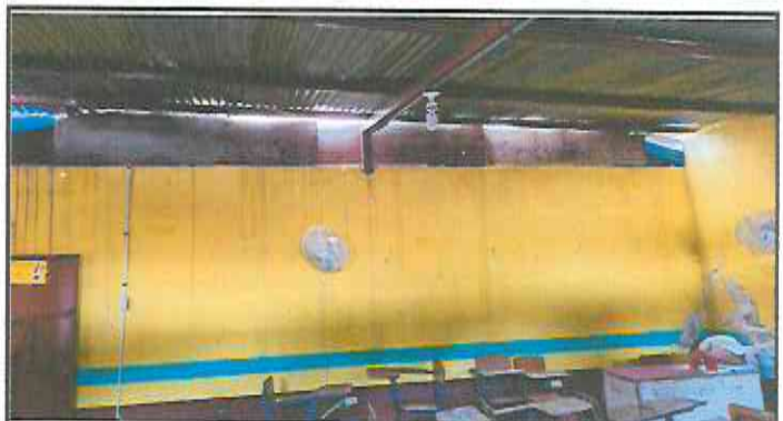
Foto4: Retiro de lámina existente, mantenimiento de estructura existente (limpieza, lijado y pintura anticorrosiva), reforzamiento de estructura con costanera de 2x6, instalación de lámina troquelada aluzinc cal. 26.
