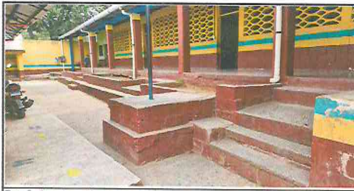
Foto5: Construcción gradas en escenario, instalación de baranda metálica en corredor, pintura en escenario, construcción de gradas de acceso al corredor y banqueta.
