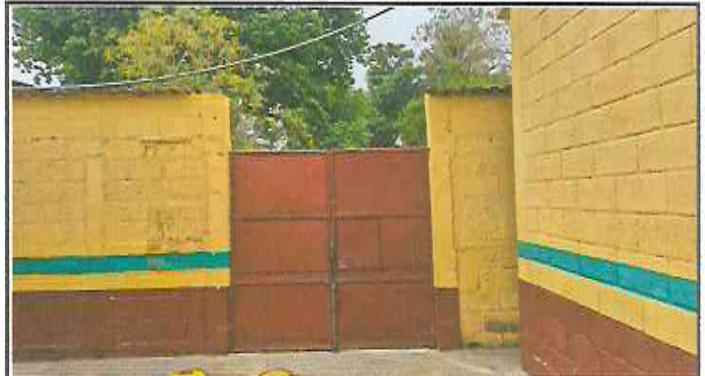
Foto2: Sustitución de portón de ingreso de 2.5m x 4.00m y techado en área de portón con costanera + lamina troquelada aluzinc cal. 26.
