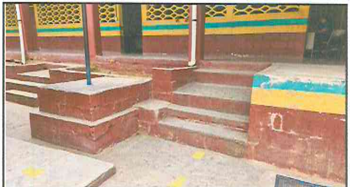
Foto4: Construcción gradas en escenario, instalación de baranda metálica en corredor, pintura en escenario, construcción de gradas de acceso al corredor y banqueta.
