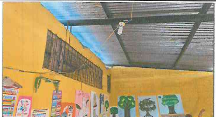
Foto 2: Retiro de lámina existente, mantenimiento de estructura existente (limpieza, lijado y pintura anticorrosiva), reforzamiento de estructura con costanera de 2x4, instalación de lámina troquelada aluzinc cal. 26.
