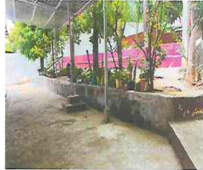
Foto 2: torta de cemento en patio de la escuela
