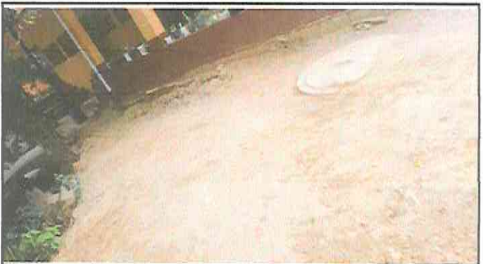
Foto 2: torta de cemento en patio de la escuela
