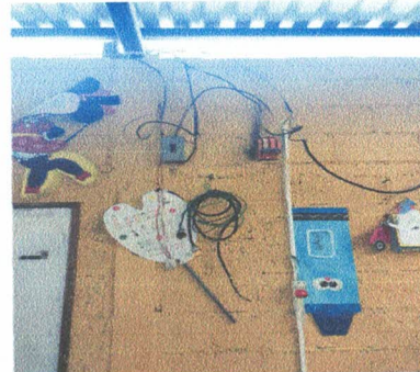
FOTO 16: REPARACIÓN DE SISTEMA DE ILUMINACIÓN Y FUERZA ( CABLE, TOMACORRIENTES, APAGADORES, FILIPONES ENTRE OTROS)
