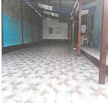
FOTO 7: INSTALACION PISO CERAMICO EN MODULO 2 LUEGO DE SER INSTALADA LA TORTA DE CONCRETO
