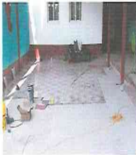
FOTO 7: INSTALACION PISO CERAMICO EN MODULO 2 LUEGO DE SER INSTALADA LA TORTA DE CONCRETO
