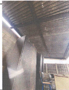
Foto 6: Sustitución de lámina por lámina y estructura de soporte metal (costanera) en módulo de dirección.
