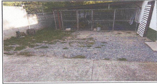
SUMINISTRO E INSTALACION DE TORTA DE CEMENTO CON ACABADO RUSTICO EN AREA DE PATIO
