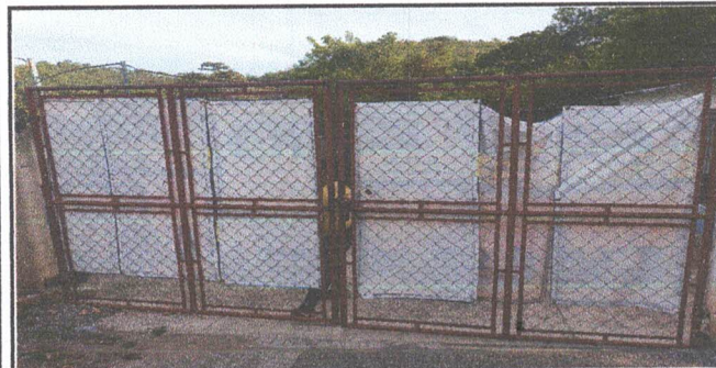
REPARACION DE PORTON DE ENTRADA PRINCIPAL, SUSTITUCION DE MALLA POR LAMINA 3/64 CON DISEÑO TROQUELADO MEDIDA DE 4.05 X 2.15 METROS
