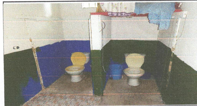
SUMINISTRO E INSTALACION DE SANITARIOS EN AREA INTERIOR DE AULAS DONDE HAY AULAS CON SERVICIOS SANITARIOS
