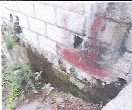
Foto 3: Punto donde el agua pluvial escorrentía sobre el muro de contención provocando humedades que dañan dicho muro.
