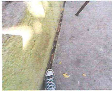
Foto 2: Separación del muro comparado con el piso de concreto actual, esto evidencia el desplome del muro y que por prevención exige la demolición del mismo y su cambio por malla y tubería HG.
