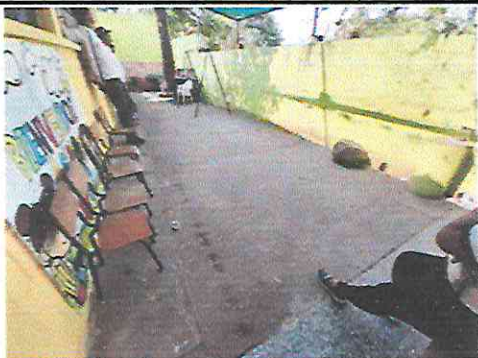
Foto 5: Piso de concreto que presenta daños por asentamiento provocado por la escorrentía del agua pluvial, en esta área se sustituirá el piso de concreto.
