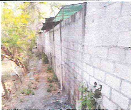
Foto 1: Muro de contención posterior el cual conduce paralelo sobre un callejón peatonal, nótese el desplome del mimos.
