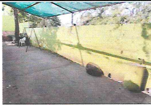
Foto 6: Muro que presenta desplome y que deberá ser demolido para evitar la falla del mismo.
