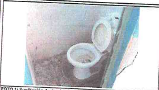
FOTO 1: Sustrucción de dos inodoros.
