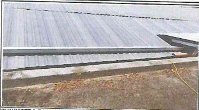
SUMINISTRO E INSTALACION DE CANAL DE 3 ML EN AREA DE AULA DE 4 GRADO
