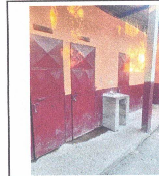
Foto 4: 2.4 MANTENIMIENTO A PUERTAS DE METAL (HERRERIA) 2.5 PINTURA DE PAREDES INTERIOR Y EXTERIOR
