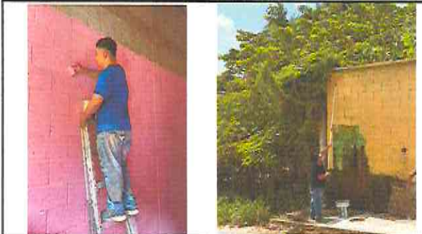
Foto 9: Pintura en paredes dañadas
