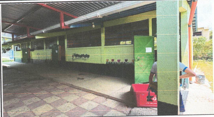
Pintura en pared frontal de 3 aulas
