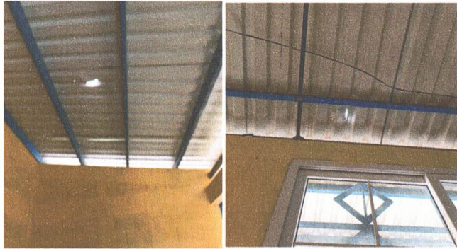
CAMBIO DE LAMINAS EN AULA 1, 2 Y 3 POR EL MOTIVO DE QUE PERSONAS INESCRUPULOSAS HAN LANZADO BOMBAS AL TECHO Y SE HAN HECHO AGUJEROS EN VARIAS PARTES DEL TECHO.
