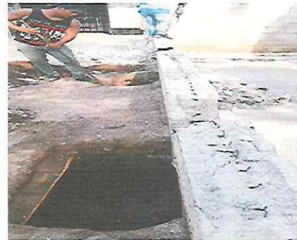
Foto 6: TAPADERA DE CAJA DE AGUA
