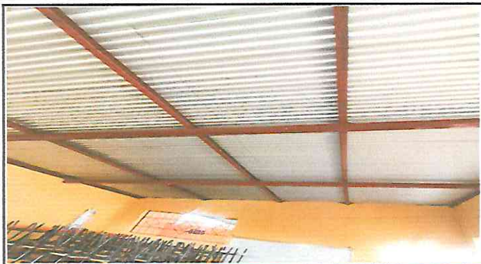
Falta de Iluminación en Aula
