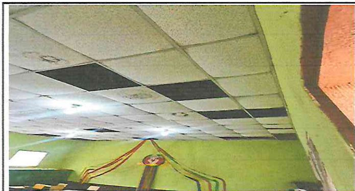
Cielo Falso Dañado por Goteras en Cubierta
