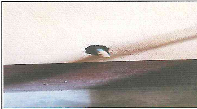
Falta de Tomacorrientes en Aula
