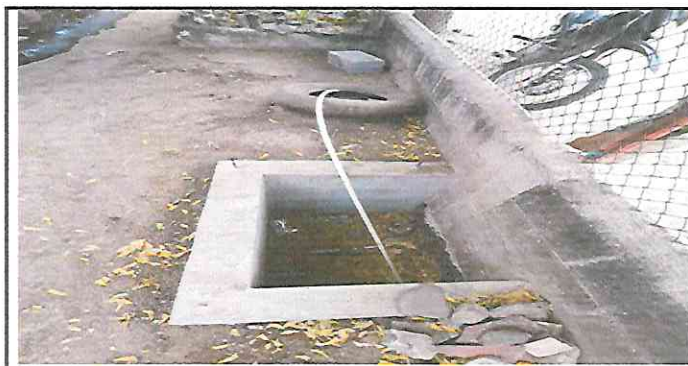
Caja de Agua sin tapadera
