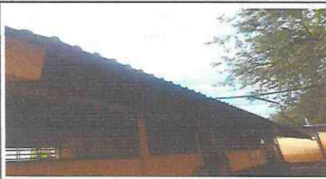
Foto 7: SUMINISTRO E INSTALACION DE CANAL EN AREA AFUERA DE TODAS LAS AULAS Y LA GALERA QUE SE HARA CONTINUA AL ESCENARIO
