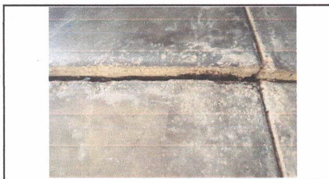
Sustitución de piso de cemento liquido por daños significativos
