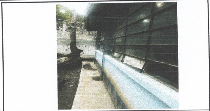
Foto 1: Sustitución de ventanas de vidrio y metal por ventanas de PVC corredizas con vidrio de 5mm de grosor ✓
