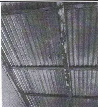
Foto 3: Estado actual del techo de aulas, la misma necesita cambio de lamina y estructura.
