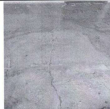
Foto 6: Piso en cocina dañado, será sustituido.
