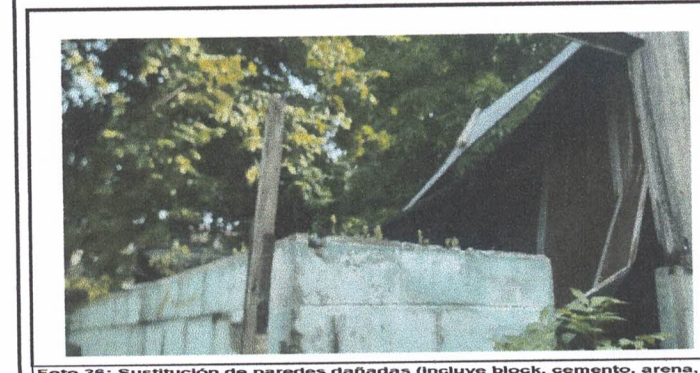
Foto 36: Sustitución de paredes dañadas (incluye block, cemento, arena, piedrín, hierro y mano de obra)
