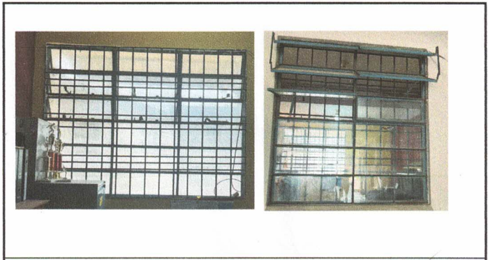
Foto 12: sustitución de vidrios por ventana PVC y mantenimiento de balcones de metal
