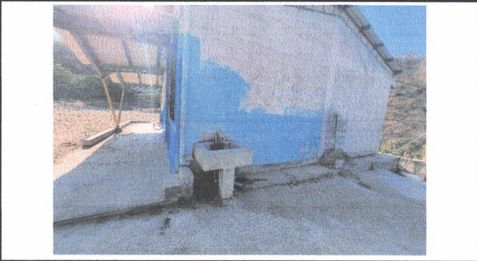
Foto 5: SUSTITUCIÓN DE LAVATRASTOS ¿ DE CONCRETO ?
