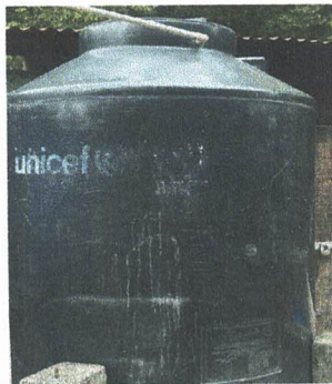
Foto 21: Sustrucción de depósito de agua de 1,100 lts dañado
