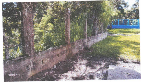
Foto 2: 1.2 Sustitución de columnas de concreto a columnas de metal de 2 mts c/u, 20 unidades
