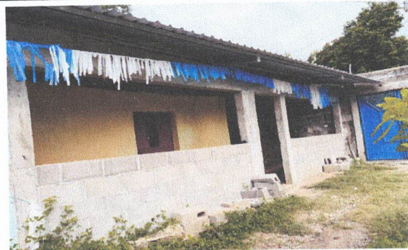
Foto 2: SUSTITUCIÓN DE PUERTA DE METAL, SUSTITUCIÓN DE BALCONES DE METAL, REPELLO Y CERNIDO EN MUROS EN AULA.
