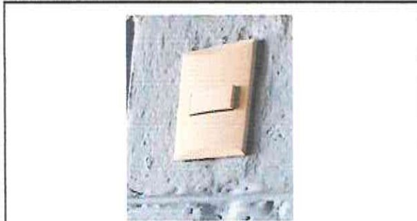
Foto 1: interruptores dañados que necesitan cambio
