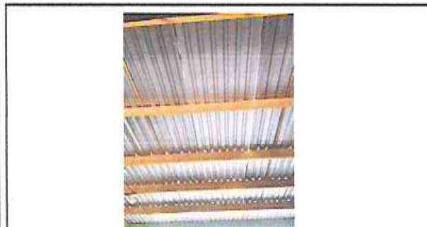
Foto 3: daños en lamina del salon de computo.
