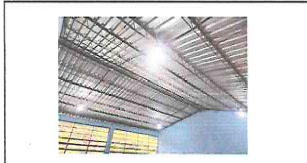
Foto 2: lamparas dañadas y sistema deficiente
